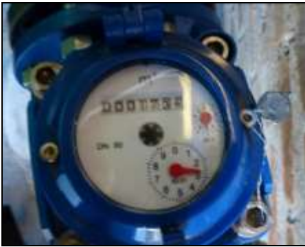
Caudal bombeado desde 29/08 al 21/10
